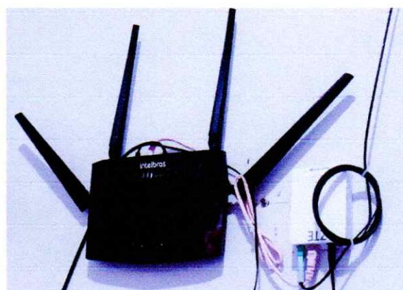
01-Roteador de 4 antenas Intelbras;
